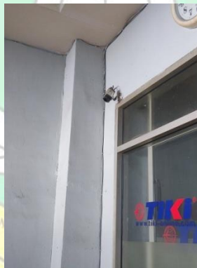
Gambar 4 Kamera Pengawas CCTV
